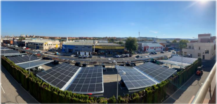
Placas Fotovoltaicas Planta Química Toledo
