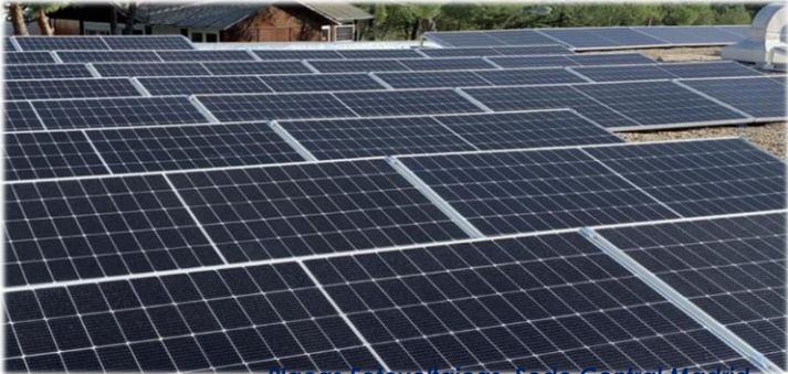
Placas Fotovoltaicas Sede Central Madrid
